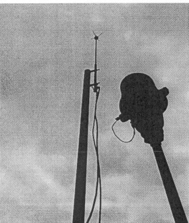
TORRE DE 30 METROS : BALIZAMIENTO Y PARARRAYOS
